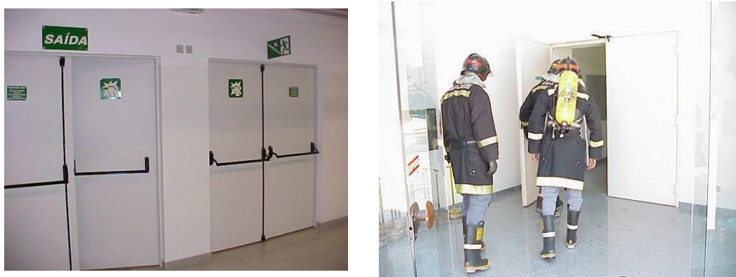
Figura 6 - Saída de emergência. Norma: Fonte: DSCI- CBPMESP
